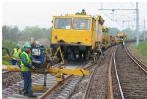
Longs Rails soudés sur traverses béton
