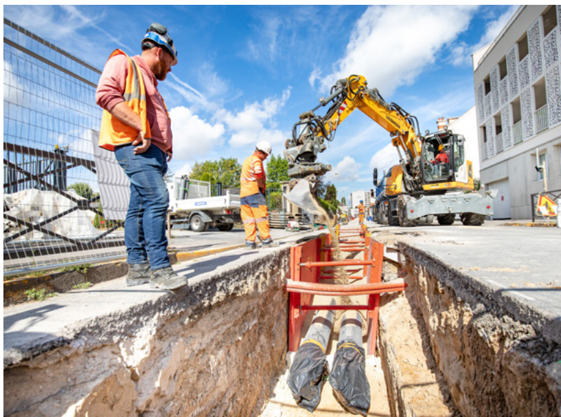
L'eau chaude (85° C) est transportée jusqu'à des sous-stations situées dans les bâtiments raccordés.
